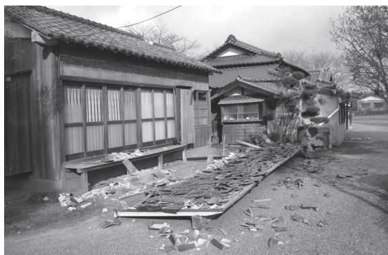
散乱する屋根瓦
